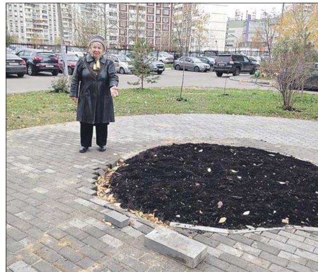
Тротуарная плитка уложена халтурно
