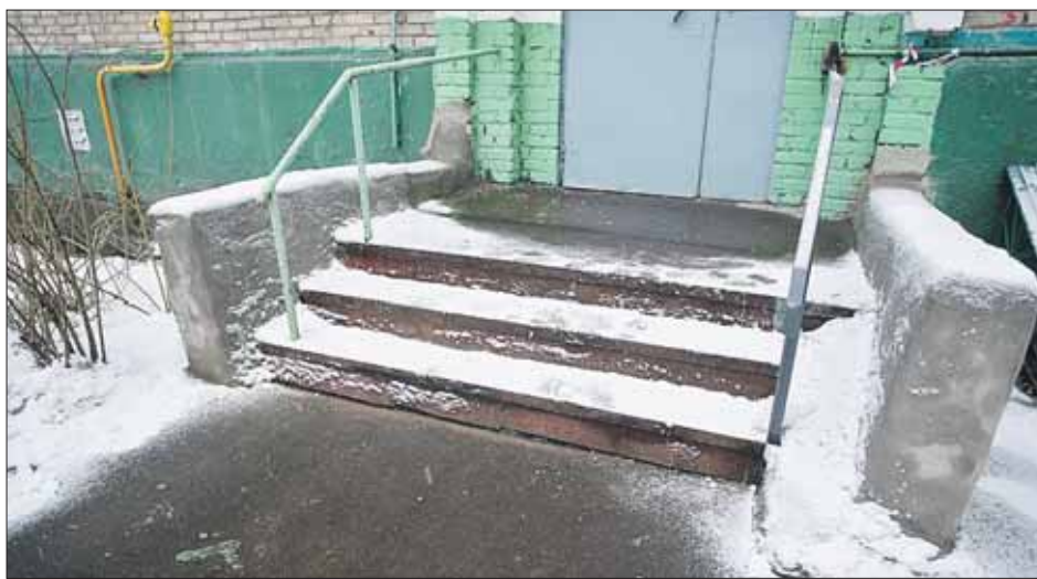
Спорные ступеньки крыльца подъезда по адресу: улица Николая Химушина, 19, корпус 3, подъезд 3
