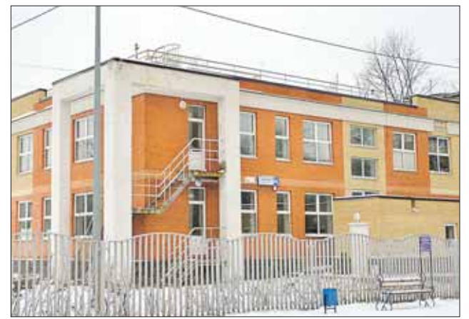
Детсаду требуется ремонт
