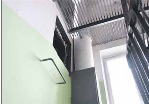
Незапертая дверь на крышу (вверху) выстужает подъезд
