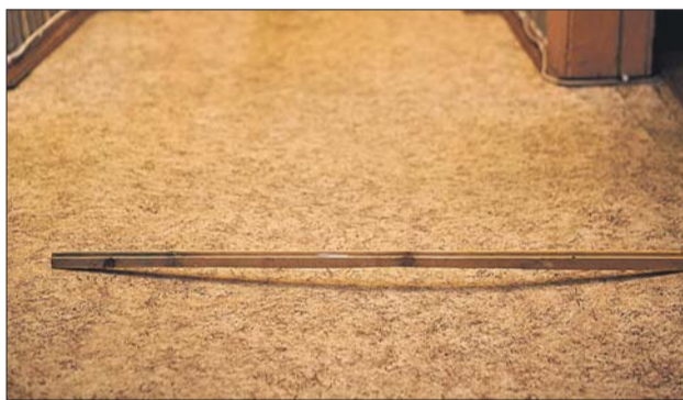
Улица Глебовская, 10. На 1-м этаже в бесподвальной части здания просел пол
