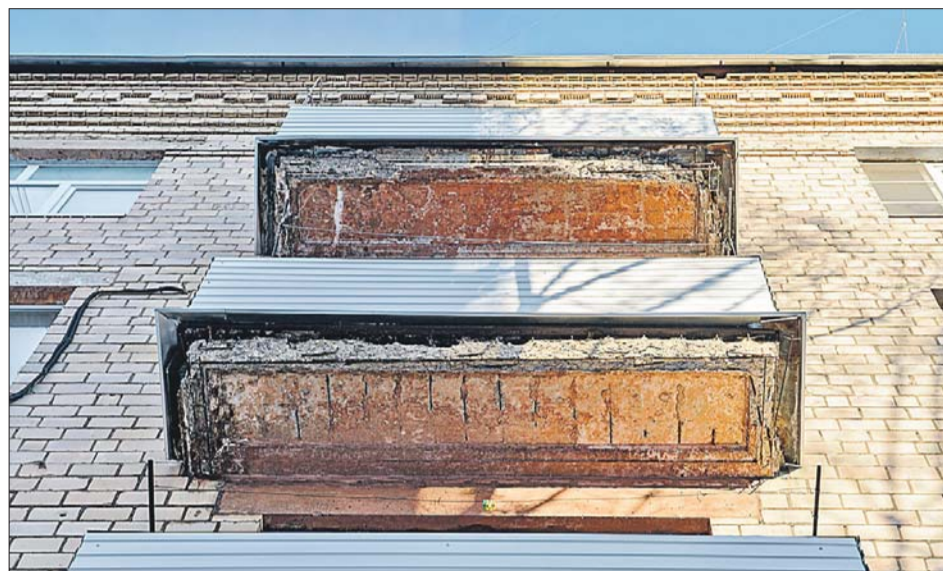
Так разрушается бетон балконной плиты на улице Гамалеи, 7, в Северо-Западном округе
