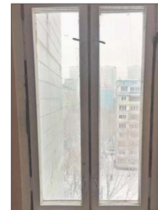
Повреждённый стеклопакет обещали заменить в ближайшее время
